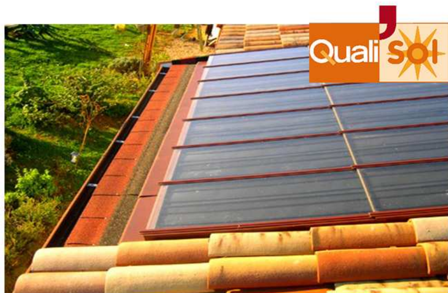
Chauffage solaire combiné, Ain (01)
